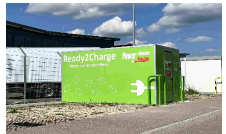
Power House für Stromspeicher
