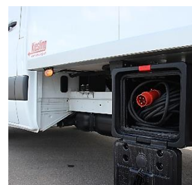
Kabel für Standkühlung seitlich installiert
